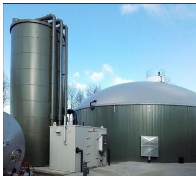
Figure 43 : Unité de désulfuration
