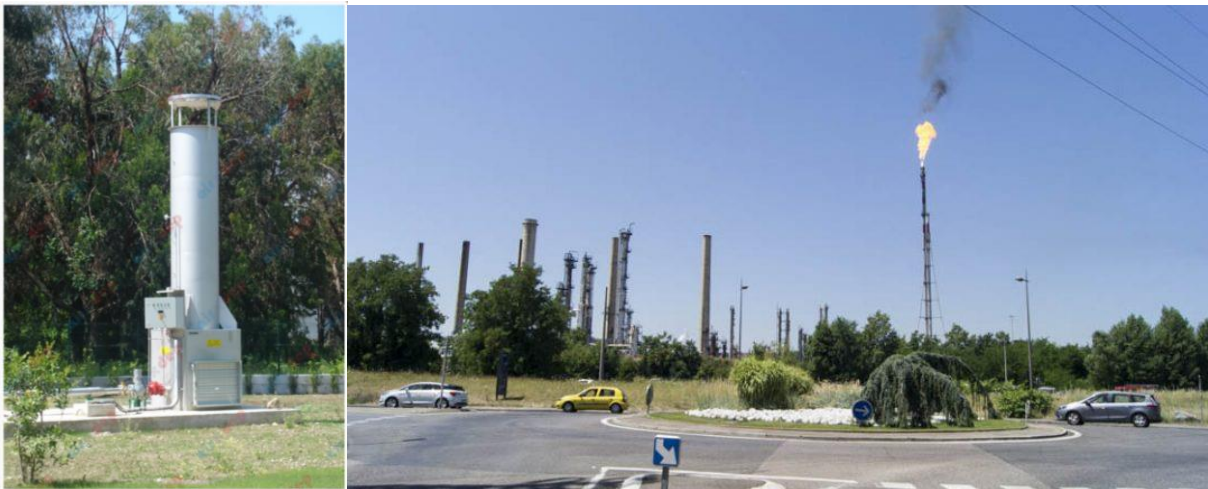
Figure 1 : Exemple de torchère de sécurité biogaz image de gauche (airdep.com) et de torchère de la raffinerie de Feyzin image de droite
